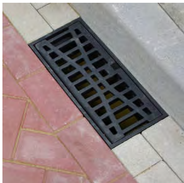
Kolk 220 langs rijbaan Parklaan
